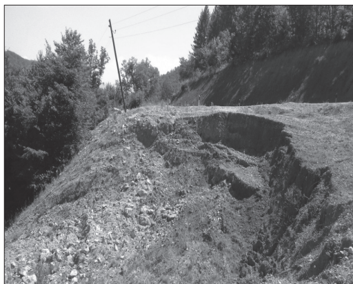
Слика 1: Клизање падине након реконструкције деонице пута Крупањ-Љубовија (извор: аутор)
